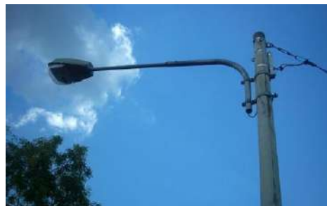
Gambar 3.12 Penerangan Jalan Umum
